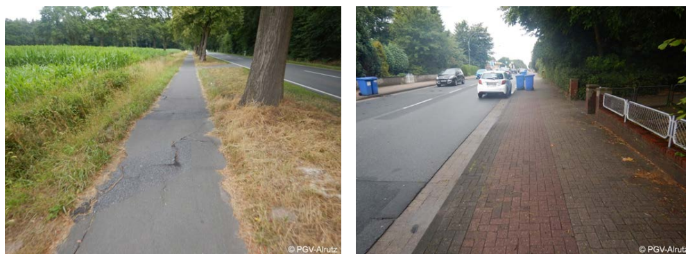
Abb. 7-15: Links: Radweg entlang der L 132 (Gemeinde Ottersberg) in unzureichender Breite und mit deutlichen Belagsschäden. Rechts: Baulicher Radweg mit Benutzungspflicht im Zuge der Embser Landstraße (L 167) in Achim in unzureichender Breite (1,2 m statt der geforderten 1,6 m)
