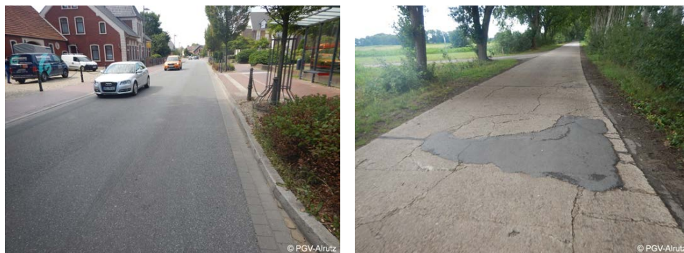
Abb. 7-16: Links: Fehlende Radverkehrsanlage bei DTV 8.500 Kfz/Tag im Zuge der Riesstraße (L 151) in der Gemeinde Ritterhude. Rechts: Belagsschäden auf der Strecke „Zur Mittelwiese“ (außerorts) in der Gemeinde Lilienthal
